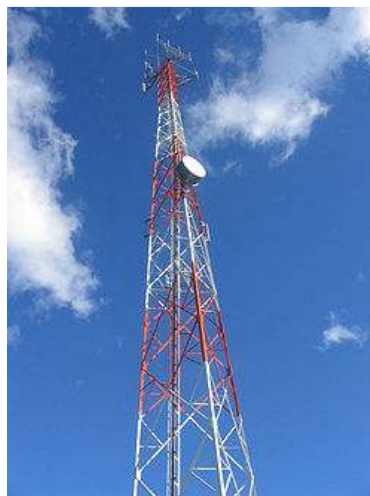
Figura 4.18. Estación base de telefonía móvil (celular).
